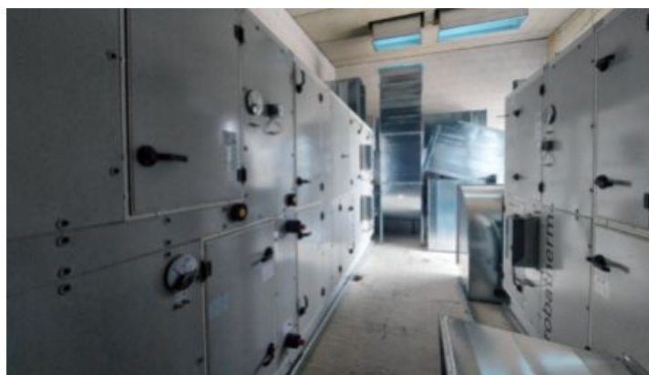
Neben den Umkleieräumen befindet sich die Gebäudetechnik der neuen Mehrzweckhalle in Lauchheim.
