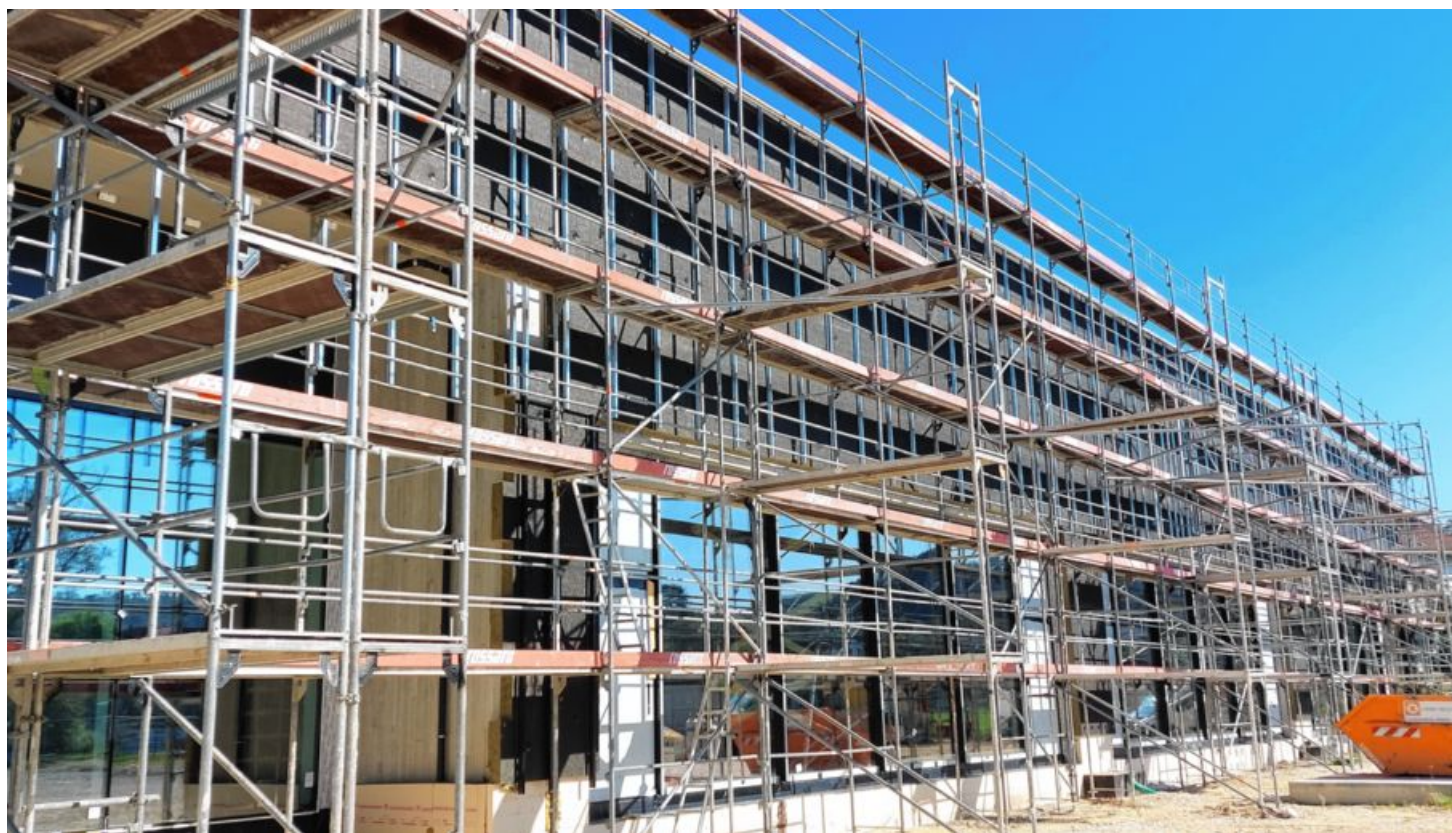
Noch ist die Halle eingerüstet. Die Außenfassade ist aber schon in Arbeit.
